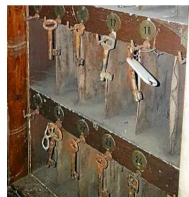
Aufgehängt und vergessen. Nun befallen Feuchtigkeit und somit Flugrost sowie Schimmel Schlüssel und Schlüsselbrett.
