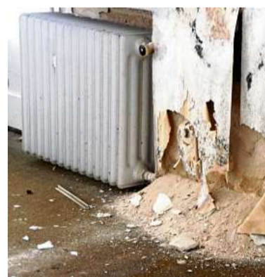
Dieses Zimmer ist verloren. Der Verfall zersetzt Mauerwerk und Putz. Auch die moderne Tapete beschönigt nichts mehr.
